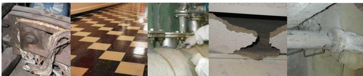
On trouve principalement des traces d'amiante dans ces matériaux
